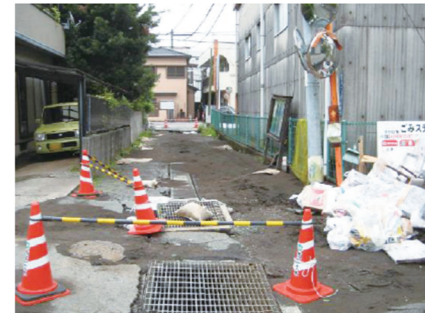
道路上への噴砂の堆積(熊本市)
