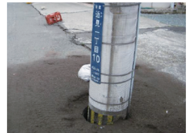
電柱の沈下(熊本市)
