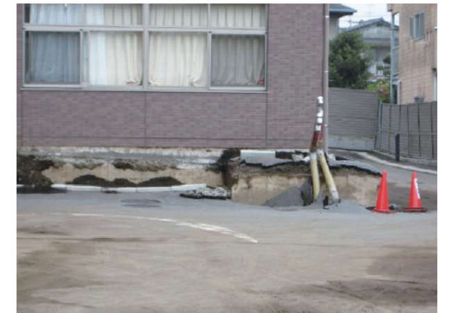
基礎杭の抜け上がりによる段差の発生(熊本市)
