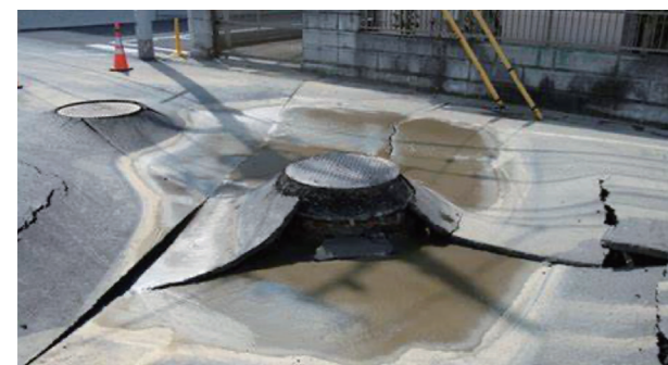
液状化現象でマンホールが浮き上がった状態
