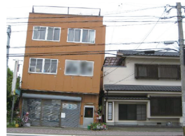
建物の傾斜・沈下(熊本市)
